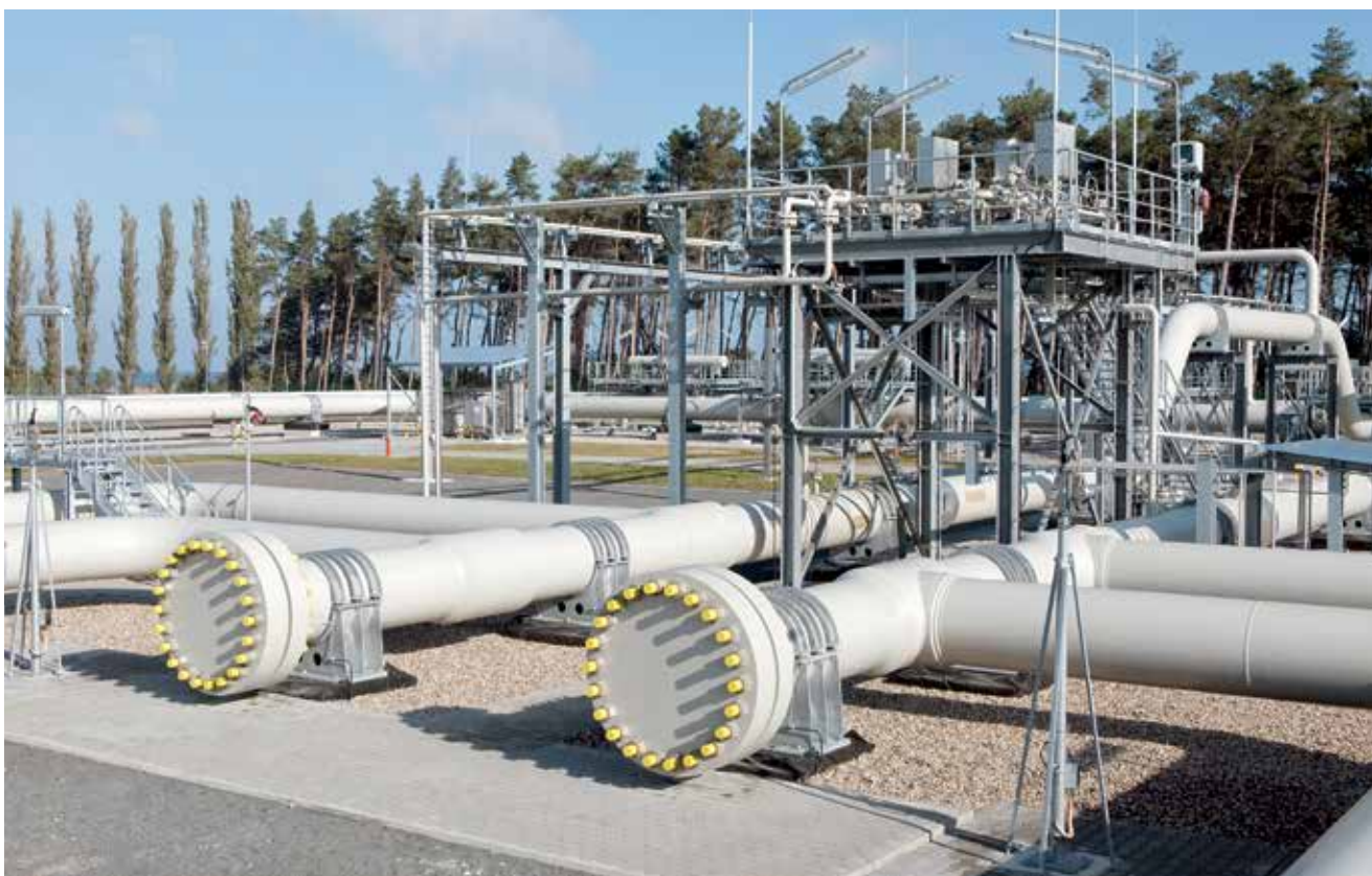
Две нитки с заглушками на торцах — это финальная точка газопровода «Северный поток» на береговом участке в Любмине. Весь комплекс береговых сооружений делится на две секции — морскую секцию газопровода «Северный поток», и береговую секцию газопроводов OPAL и NEL, по которым газ будет направляться дальше в европейскую газовую сеть.
