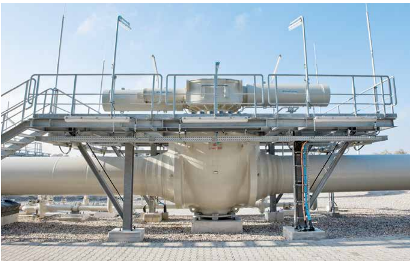
Большинство запорной арматуры, используемой на береговых сооружениях – это шаровые краны, которые служат для обеспечения безопасности. В аварийной ситуации они немедленно перекрывают поток газа. Все краны разработаны и изготовлены специально для проекта Nord Stream итальянской компанией PetrolValves S. r. l.
