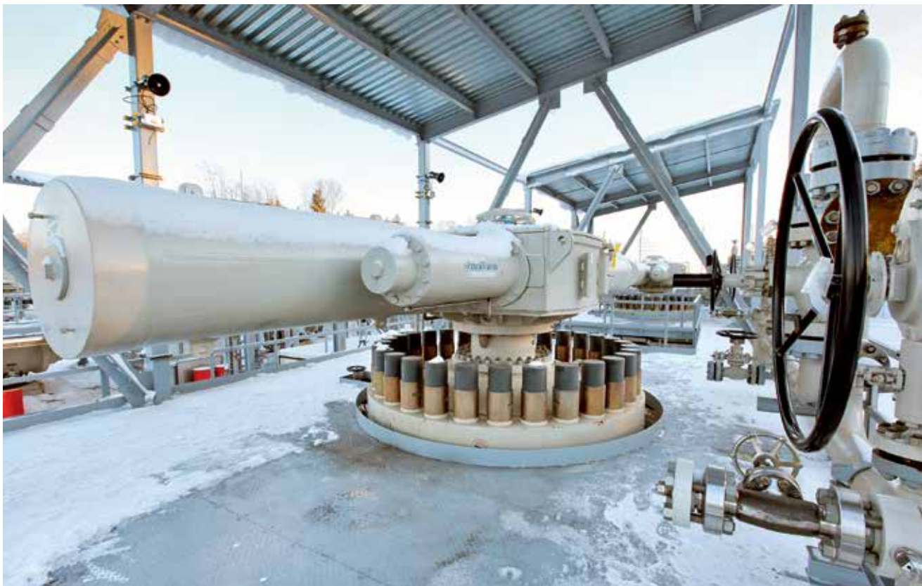
Аварийные клапаны расположены на береговых участках России и Германии. В случае аварийной ситуации они автоматически перекрывают подачу газа в газопровод или из него. Исполнительные механизмы, разработанные специально для проекта Nord Stream, позволяют полностью закрыть клапан за одну минуту.
