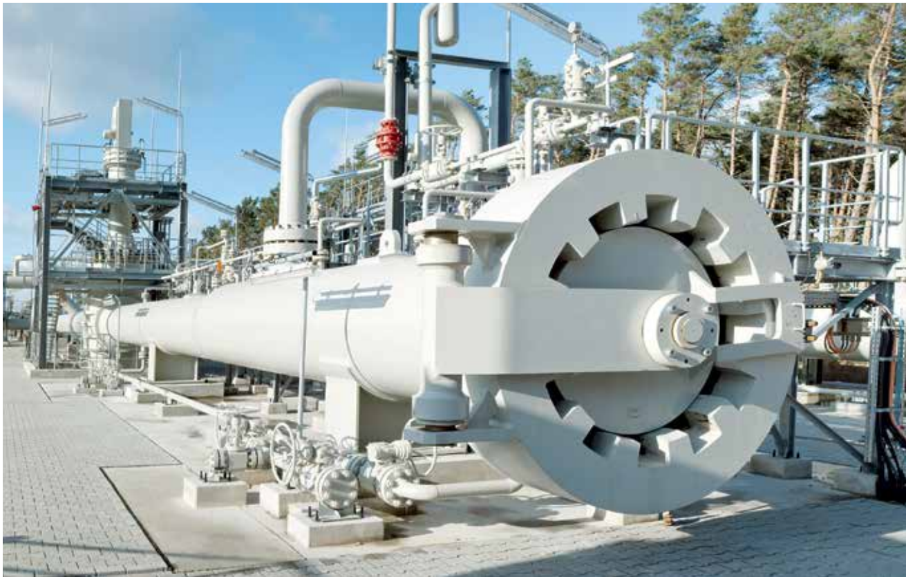
Камеры приема поршней установлены в конце каждой нитки газопровода «Северный поток» в Любмине. Они позволяют безопасно извлекать из труб диагностические и очистные устройства, запускаемые через камеру запуска в России. Поршни движутся вместе с потоком газа и могут обнаружить минимальные изменения характеристик труб.
