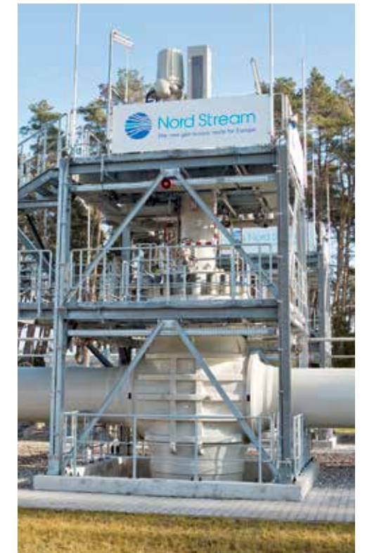
Шибберная задвижка на участке береговых сооружений в Германии изолирует газ в газопроводе «Северный поток» от камер приема поршней, когда они не используются. Задвижки имеют высоту около 10 метров и вес 102 тонны.
