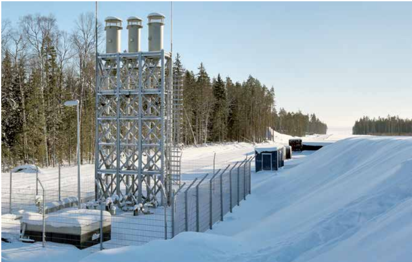
Газопровод «Северный поток» начинается в 1,5 км от берега с береговых сооружений, которые включают камеры запуска диагностических и очистных устройств и системы аварийного отключения. В случае аварии или плановой остановки газопровода газ будет стравлен через свечные стояки (на фото выше). На каждой нитке газопровода есть свечной стояк.
