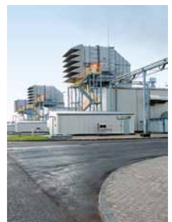
Blick auf drei der acht Gaspumpeinheiten, in denen das Gas für die lange Reise durch die Ostsee auf Druck gebracht wird.
