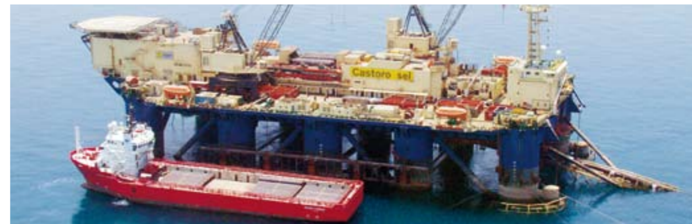
Im Frühjahr 2010 werden die ersten Rohre zur Verlegung an die „Castoro Sei“ geliefert werden.
