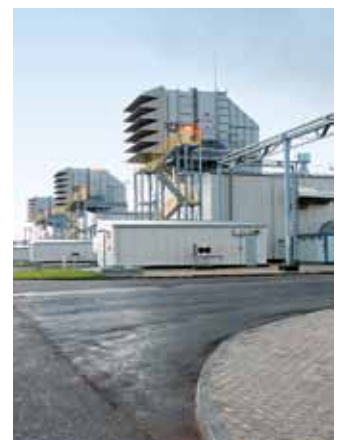
Kuvassa kolme Portovajan kompressoriaseman kahdeksasta kaasunpumpausyksiköstä.
